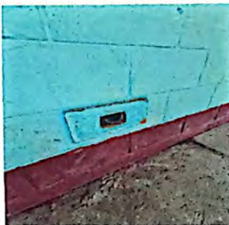
Foto 5: conecciones de tomacorrientes sin placas y tapaderas modulos I, II Y III
